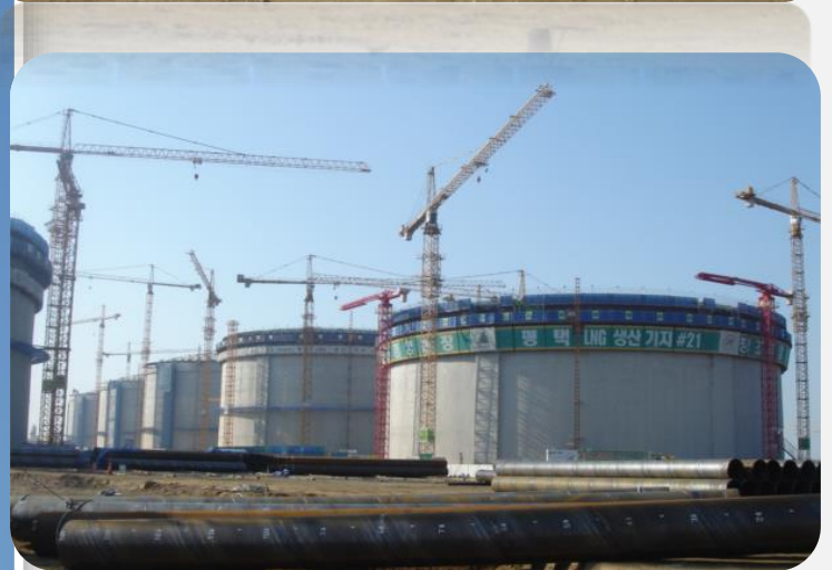
LNG GAS STORAGE PLANT
